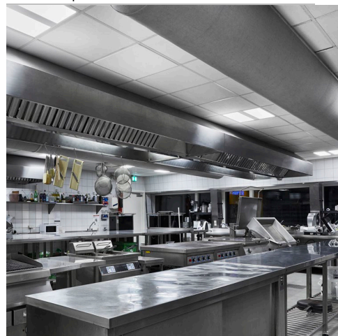
Køkkenet med 32 Panel Protect-armaturer, der giver lav blænding og justerbart lys til personalet.
